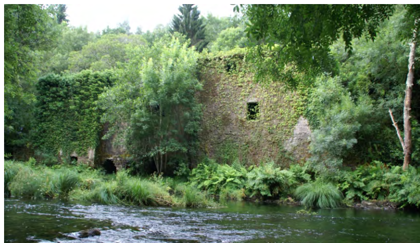
As imaxes desta páxina mostran o deterioro que foi sufrindo a edificación ata a actualidade.
